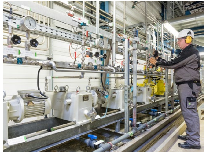
Überwachung der Kraftwerkanlagen. Foto: WISAG
